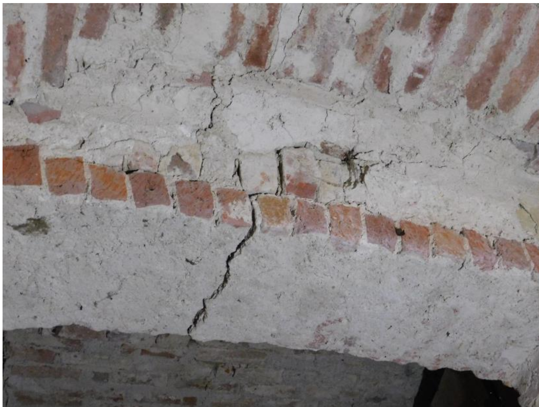
Fig. 13. Vista lesione architrave in muratura
