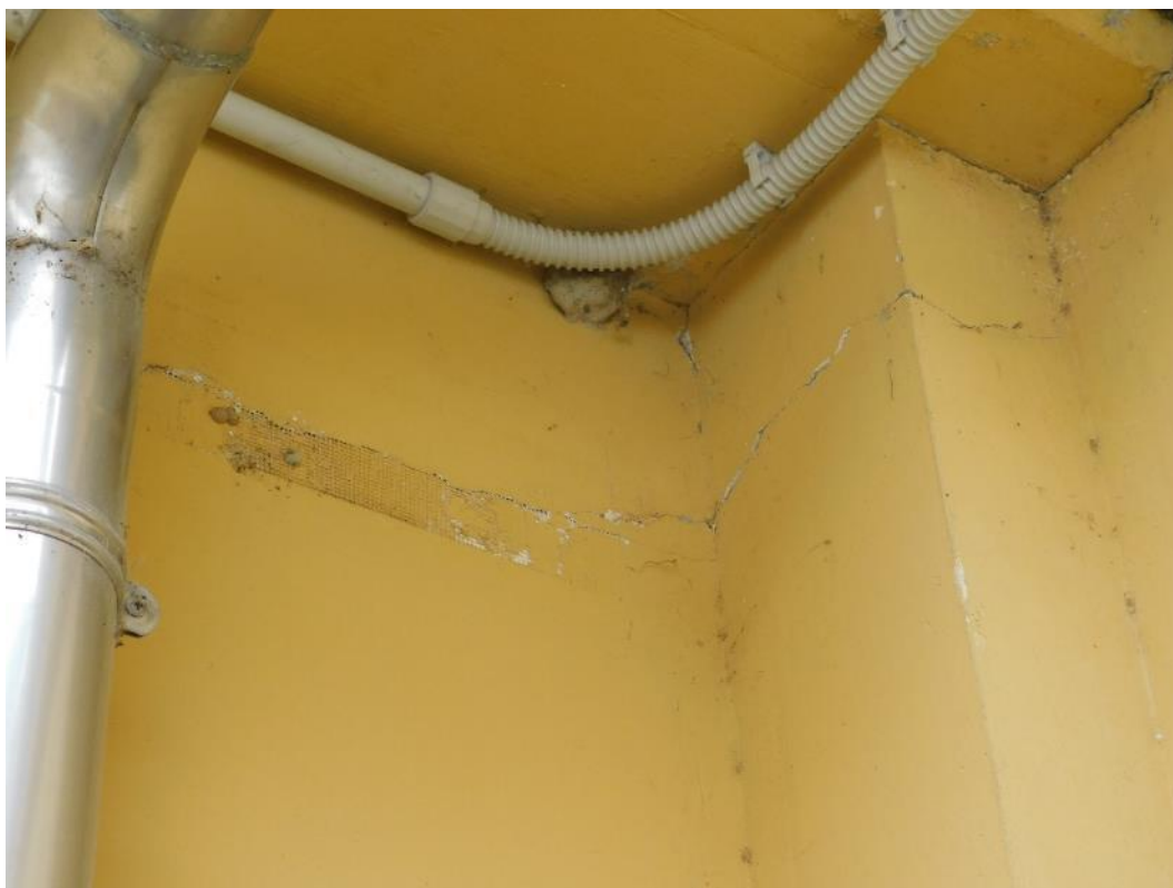
Fig. 8. Vista ravvicinata lesione sub-orizzontale
