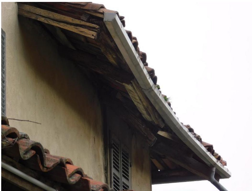
Fig. 14. Vista ammaloramento copertura in legno fabbricato B
