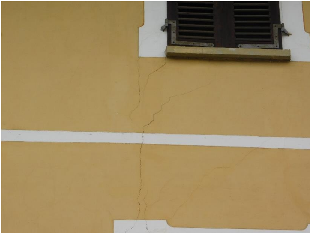
Fig. 10. Vista lesione verticale piano primo
