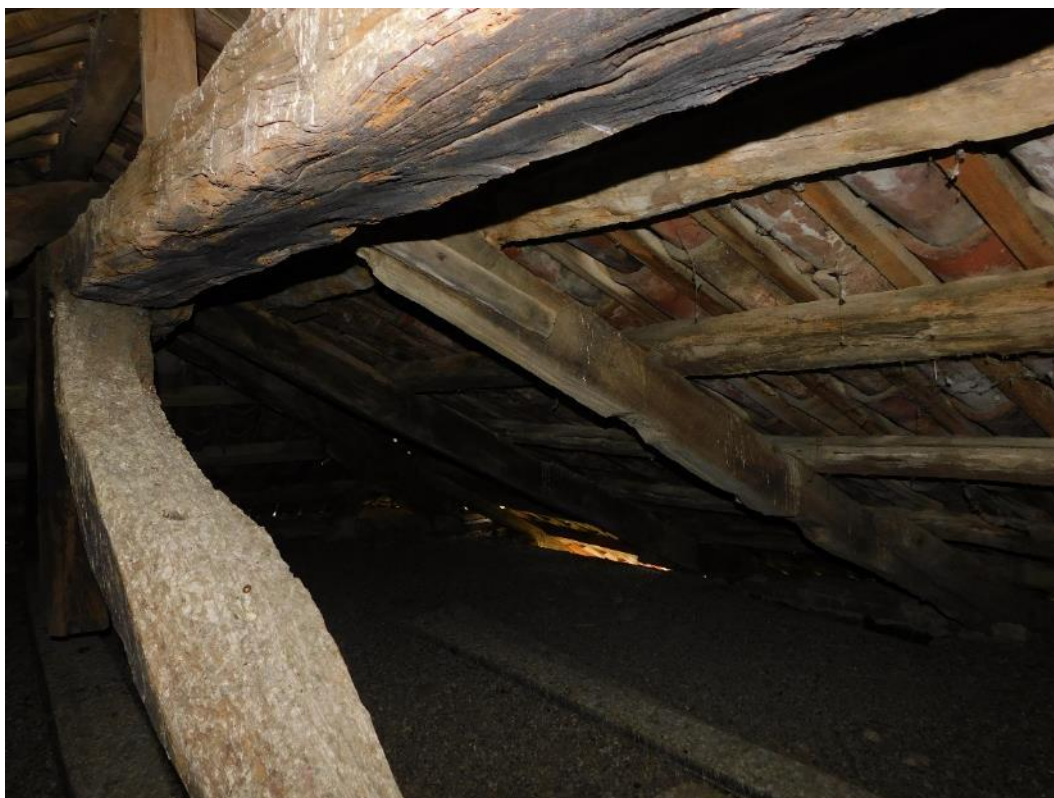
Fig. 15. Vista ammaloramento copertura in legno fabbricato B
